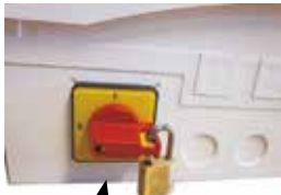
Interruptor principal de mantenimiento
