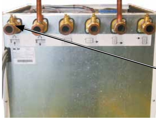
Purgador manual en la entrada de agua glicolada
